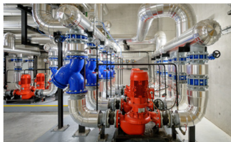
Une chaufferie biomasse
