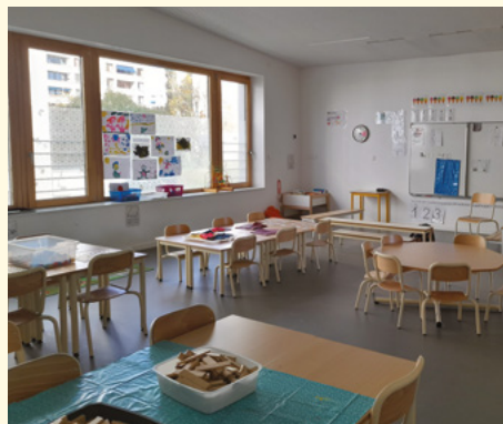
Salle de classe équipée d'un système de ventilation au plafond.
