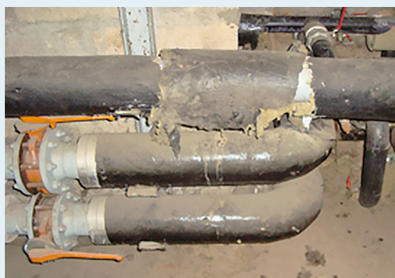
Calorifugeages dégradés. Source : Cerema
