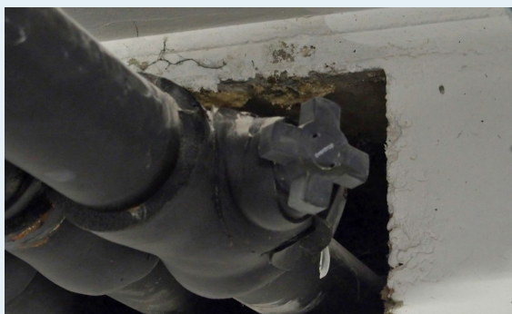
Exemple de conduit de soufflage isolé équipé d'une vanne d'équilibrage.
