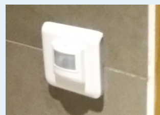
Détecteur de mouvement dans des sanitaires Source : Cerema
