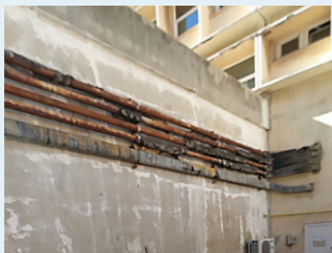
Calorifugeages extérieurs dégradés. Source : Cerema
