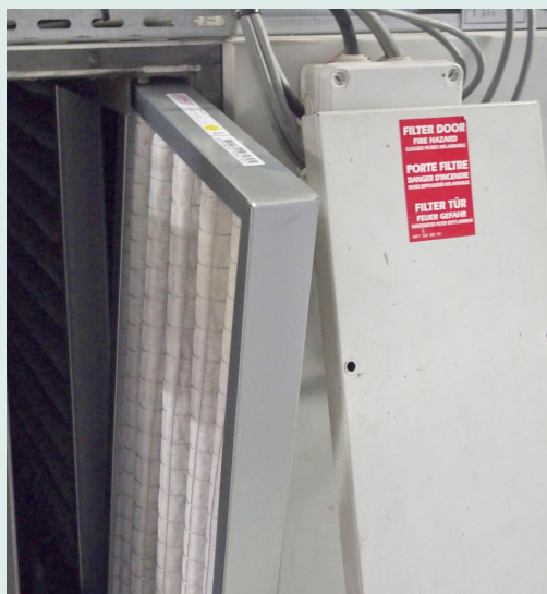
Filtre d'une centrale de traitement d'air (CTA). Source : Cerema
