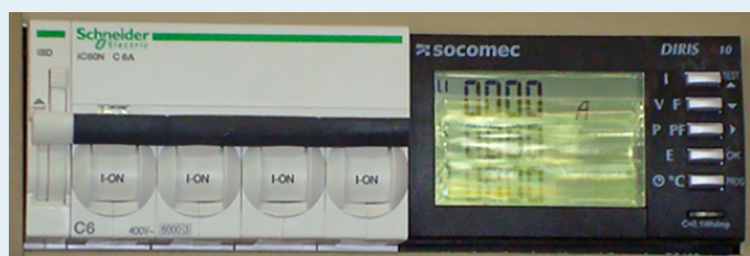
Compteur d'énergie électrique sur quatre départs de convecteurs électriques. Source : Cerema
