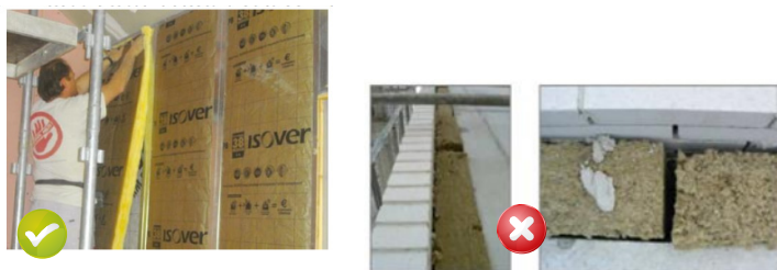
Illustration 4 - Bonnes et mauvaises pratiques observées : panneaux d'isolants bien placés et proches les uns des autres ; isolation mal posée où les différents blocs d'isolants ne sont pas collés et sont décalés provoquant des fuites d'air.
