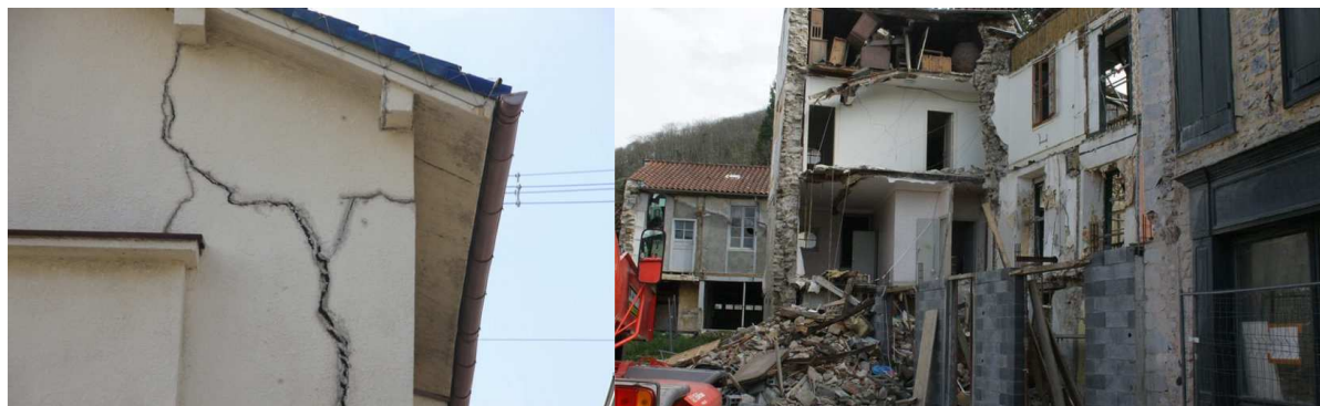
Figure 32: Impacts du RGA sur les bâtiments (Source : la Gazette des communes)
