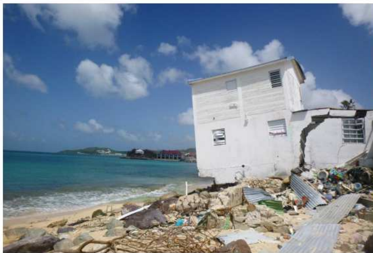
Figure 49: Basculement d'une habitation dans le vide à Sandy Ground (Saint-Martin) (Source : BRGM, Impacts du cyclone IRMA sur le littoral des « Illes du Nord » à Saint-Martin et Saint-Barthélemy, octobre 2017)
