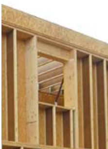
Caissons d'insufflation en bois. ©AQC-2015
