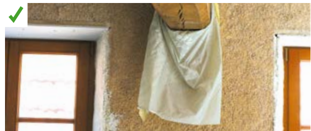
Couverture du bois apparent avec un plastique lors d'un remplissage en béton de chanvre. ©AQC-2015
