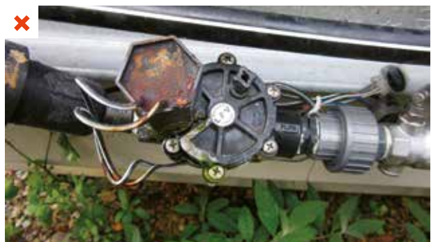
Plusieurs bacs de plantes ne sont pas irrigués correctement. Deux électrovannes présentent des dysfonctionnements. Elles sont très exposées aux intempéries et montrent des traces importantes d'oxydation au niveau des composants électriques. ©AQC
