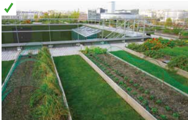
Une structure légère en ossature métallique recouvre les édicules techniques de la toiture. Elle permet d'accueillir un potager. Pour respecter les charges admissibles, les zones de circulation engazonnées ont été réalisées sur un substrat de faible épaisseur. ©AQC
