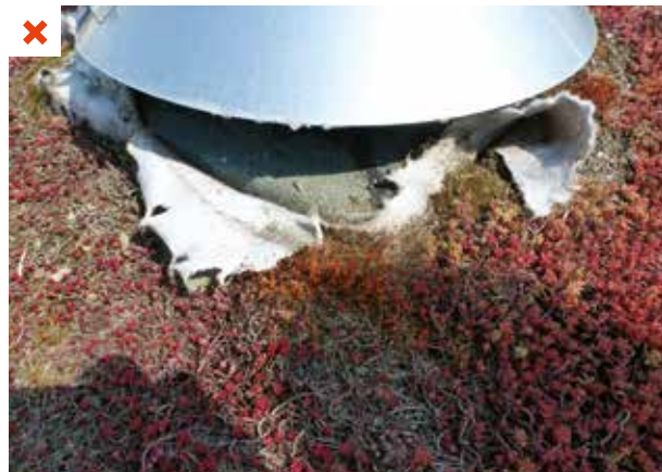
Le mauvais traitement des points singuliers, notamment des sorties en toiture, ne permet pas d'avoir un accès facile à la couche d'étanchéité.
