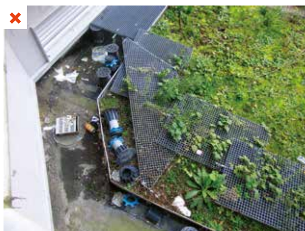
Lors d'une intervention pour déboucher une évacuation d'eau pluviale, les plots et les grilles n'ont pas été remis en place. Le couvert végétal est malmené. ©AQC
