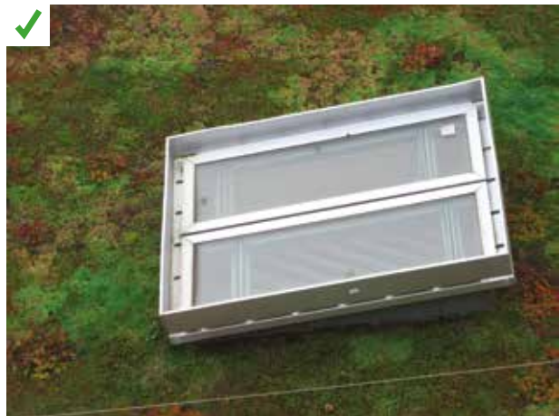
Un lanterneau à double vantail ouvrant vers l'extérieur permet un accès direct à la surface végétalisée. L'ouverture est située dans un large couloir de distribution. Les interventions ne perturbent pas les occupants. ©AQC
