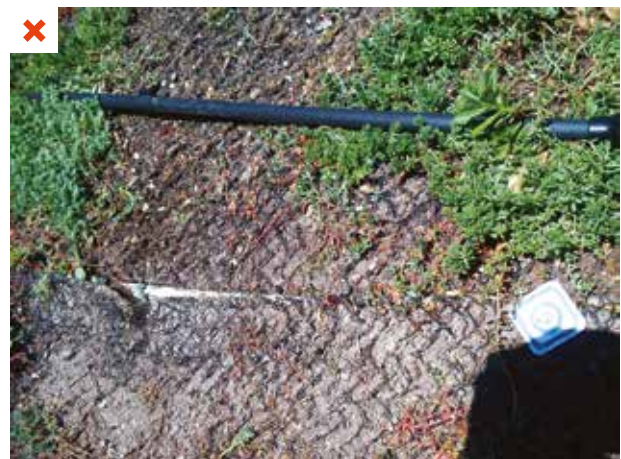
Sur cette toiture végétalisée en pente forte, la maille d'accroche qui sert à retenir le substrat est déchirée. Le substrat ne résiste plus à l'érosion et le couvert végétal a disparu sur de larges zones. ©AQC
