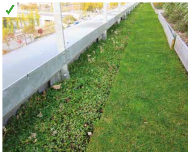
Bande stérile aménagée en utilisant des caissettes à planter modulaires en plastique. Le couvert végétal est maintenu jusqu'en limite d'acrotère. En cas de besoin d'accès à la couche d'étanchéité les caissettes sont facilement amovibles. ©AQC
