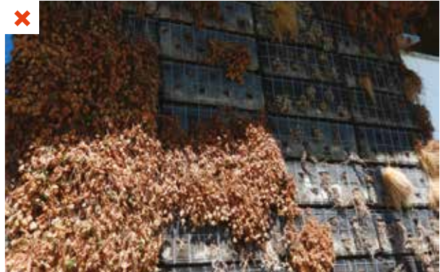
De nombreuses fuites dans le circuit d'arrosage ont détrempé la sphaigne (substrat). Les racines ont pourri. Ne pouvant plus se nourrir correctement, les plantes sont mortes. ©AQC
