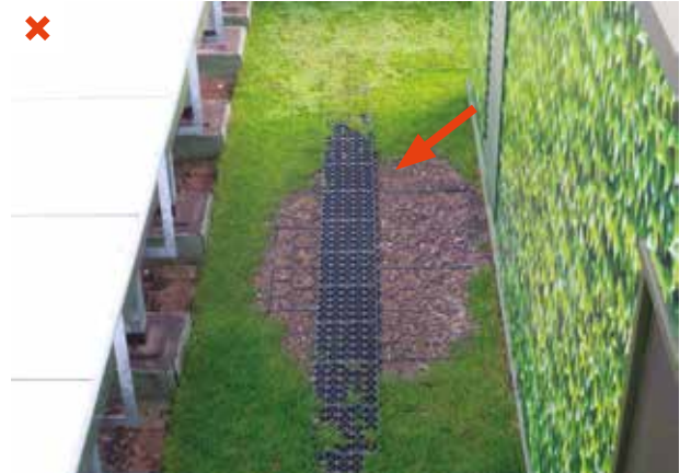
Absence de couvert végétal en contrebas de la grille de protection du rejet d'air chaud. ©AQC
