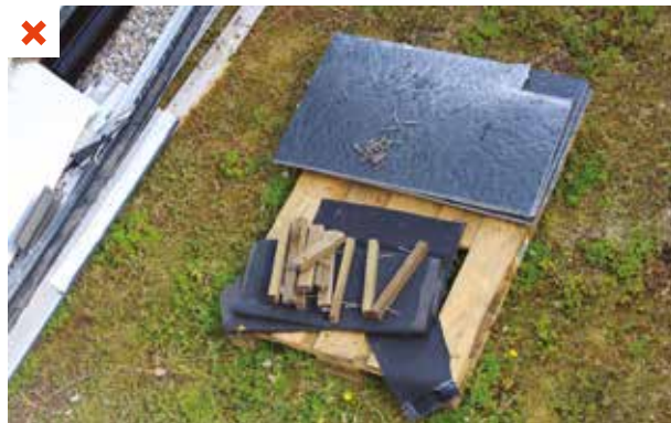
À la fin de la phase travaux, la zone végétalisée sert de plan de travail. ©AQC
