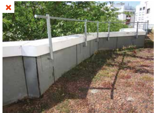
La palette végétale choisie pour cette toiture très exposée ne résiste pas. Les plantes se développent uniquement en bordure d'acrotère et dans les zones protégées du vent et du soleil par les bâtiments mitoyens. ©AQC
