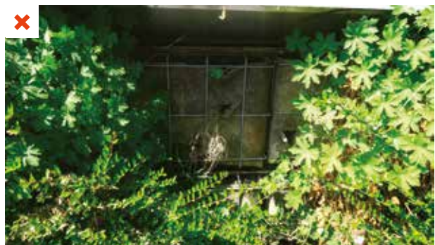
Plusieurs gicleurs sont obstrués par des bouchons de calcaire. En plusieurs points de la paroi végétalisée, le substrat est totalement sec. ©AQC
