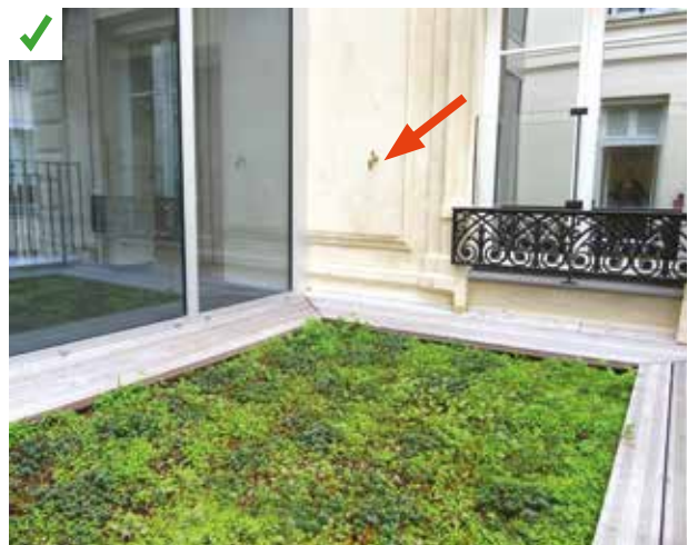
Lors de la rénovation du réseau de plomberie, des robinets extérieurs ont été installés pour chacune des petites terrasses végétalisées. ©AQC
