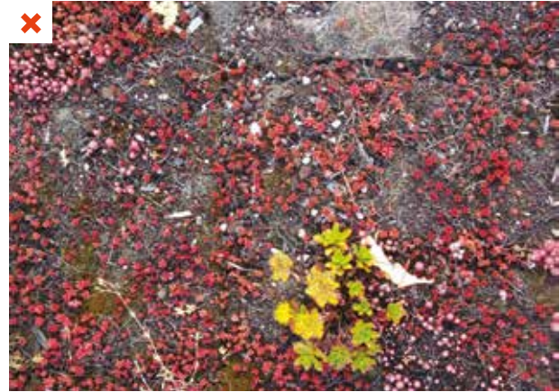
La couche filtrante affleure par endroits. L'épaisseur du substrat devient insuffisante. ©AQC
