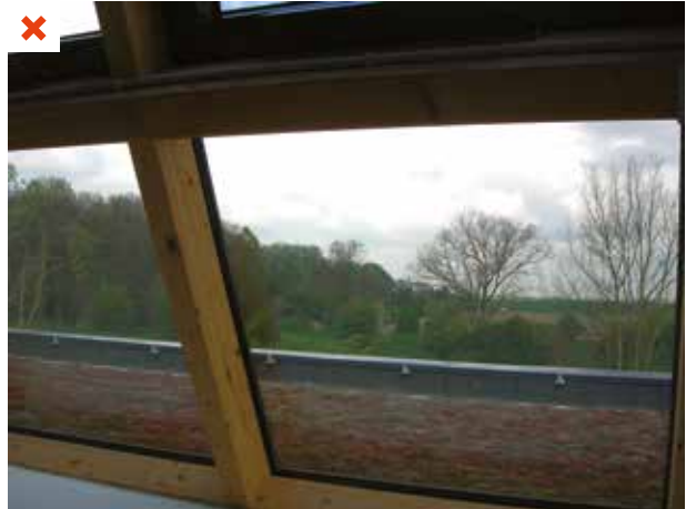
L'accès aux surfaces extérieures n'est pas adapté. ©AQC
