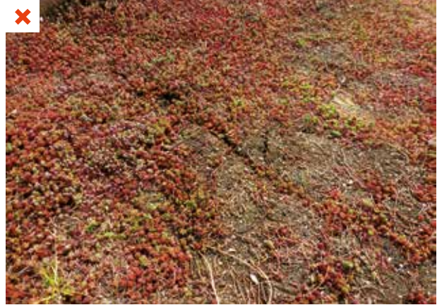
Le tapis végétal de sedum non arrosé subit un stress hydrique. ©AQC
