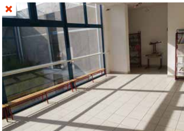
Exposition importante aux rayons solaires à cause de la grande surface vitrée orientée sud et sans protection solaire. Cette exposition est à l'origine des surchauffes en mi-saison et en été. ©AQC
