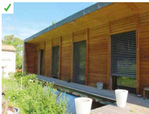
Brise soleil orientables (BSO) positionnés à l'extérieur et contribuant, en complément de la casquette correctement dimensionnée, à éviter les surchauffes et l'éblouissement en été sur la façade sud. ©AQC
