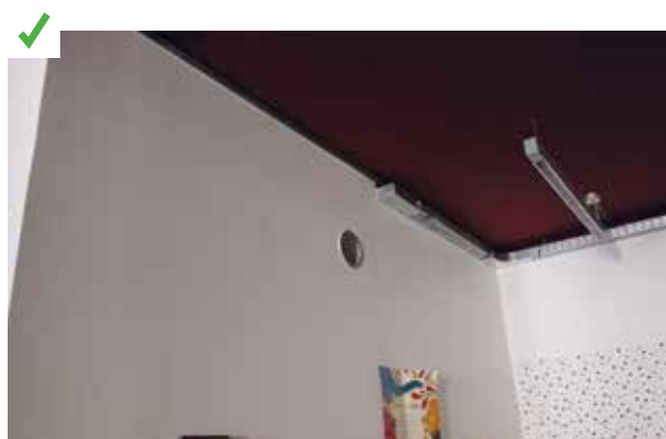
Bouche d'extraction du déstratificateur installé dans une médiathèque permettant d'homogénéiser la température de l'air intérieur et créer un courant d'air. ©AQC
