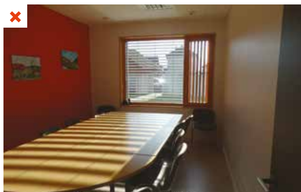
Fenêtre pourvue d'un dispositif anti-intrusion (à droite) pour ventiler les locaux la nuit en période chaude. Elle n'est pas utilisée par les usagers malgré la consigne d'ouverture avant de quitter les locaux, en fin de journée. ©AQC
