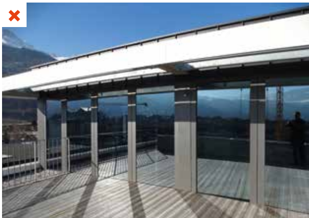
Inconfort thermique dans ces locaux malgré l'utilisation d'une casquette solaire métallique et de vitrages à basse émissivité et à contrôle solaire. Ces solutions ne sont pas suffisantes. Une simulation thermique dynamique aurait permis d'identifier l'inconfort en amont et d'adapter les dimensions des ouvertures et des protections solaires. ©AQC
