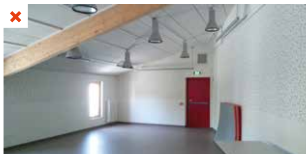
Salle présentant une seule menuiserie extérieure. La ventilation naturelle traversante n'est pas assurée puisque la porte doit rester fermée pour des raisons de sécurité. ©AQC
