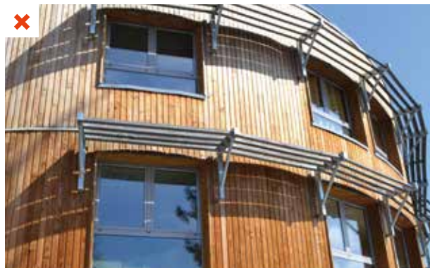
Protections solaires sous-dimensionnées. ©AQC
