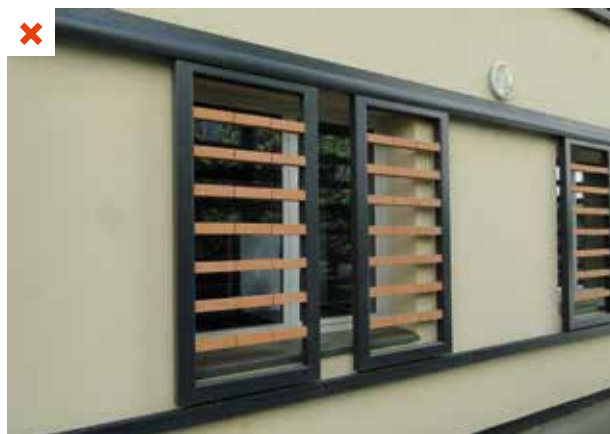
Brise-soleil coulissants sous-dimensionnés. ©AQC
