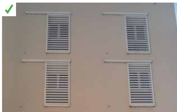
Les occupants de ce bâtiment ont fermé les brise-soleil coulissants sur cette façade exposée ouest avant de partir au travail. ©AQC
