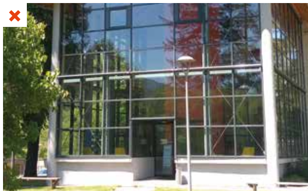
Surface importante du mur rideau sans protection solaire orienté sud. ©AQC
