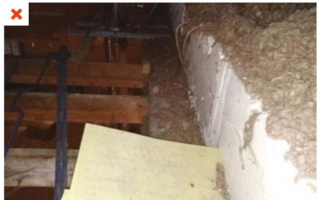
Aucune rehausse périphérique n'a été mise en place pour contenir l'isolant. ©AQC
