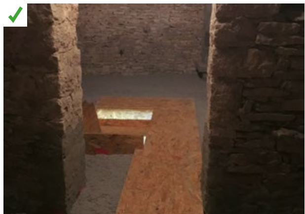
Le cheminement technique permet d'inspecter l'ensemble du comble et d'intervenir aisément. ©AQC
