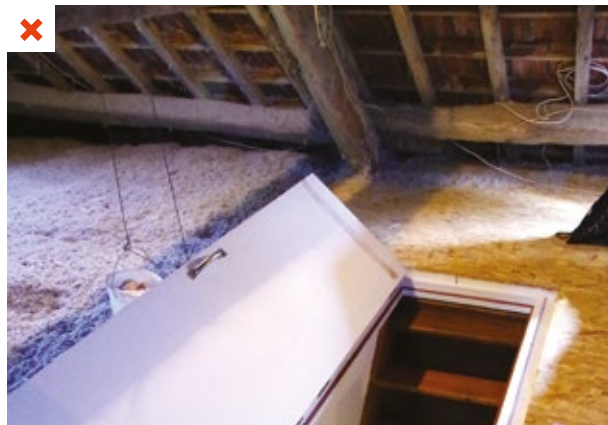
Trappe d'accès aux combles non-isolante. ©AQC
