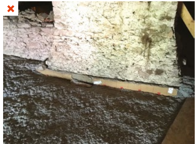
Absence de coffrage rigide et non respect de la distance de sécurité. L'isolant non combustible mis en œuvre ne permet pas d'assurer la distance nécessaire. ©AQC
