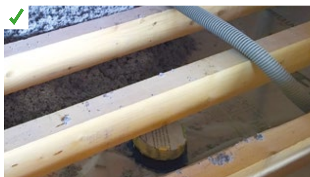
Un capot de protection adapté recouvre le spot encastré. Le traitement de l'étanchéité à l'air englobe le dispositif. ©AQQC
