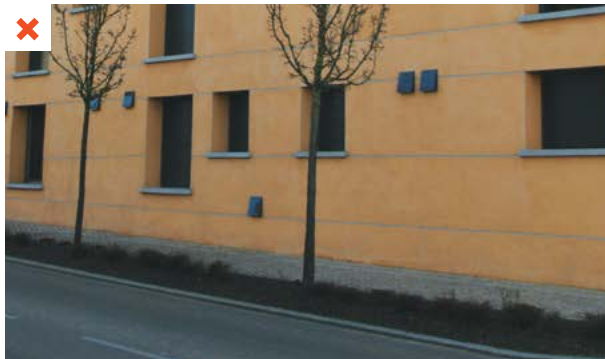
La présence de modules de ventilation sur cette façade entraîne une gêne à l'intérieur des locaux donnant sur la rue très passante. ©AQC
