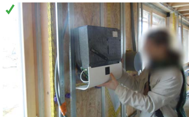
Ventilation double flux décentralisée installée à hauteur d'homme, facilement démontable et ne nécessitant pas d'outils ce qui simplifie l'entretien. ©AQC
