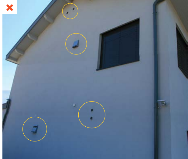
Multiplication d'éléments en façade jugés peu esthétiques par la maîtrise d'ouvrage. ©AQC
