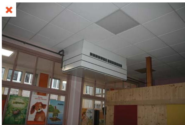
✗ Évacuation des condensats nécessitant une pompe de relevage car le module est suspendu au plafond et placé loin d'un point d'évacuation d'eau usée. ©AQC
