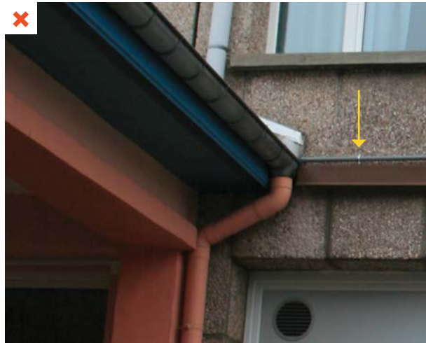
✗ L'évacuation des condensats se fait en extérieur vers une descente d'eau pluviale. L'eau de condensation a gelé dans la canalisation qui s'est bouchée. ©AQC
