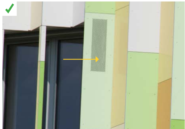
Les prises et rejets d'air sont intégrés architecturalement grâce à la création d'éléments de bardage perforés. ©AQC
