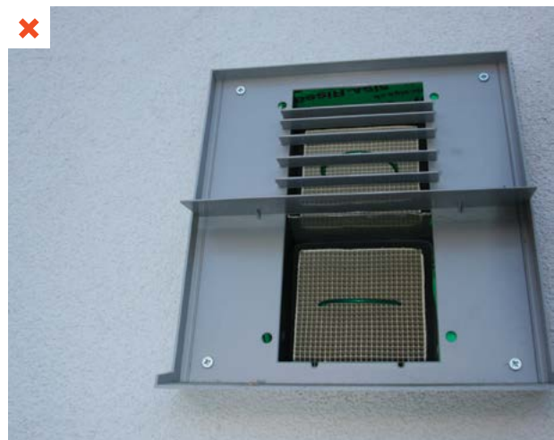
L'accès à l'échangeur/accumulateur nécessite le démontage manuel du capot et le dévissage du support. ©AQC
