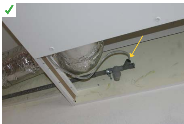
✓ Évacuation gravitaire des condensats vers une canalisation d'eau usée (lavabo présent dans la salle de classe). ©AQC
