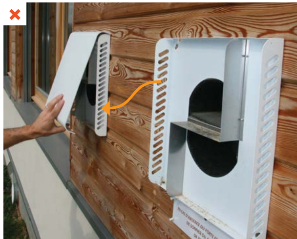
Deux modules identiques, à fonctionnement continu, ont été installés côte à côte. La prise d'air neuf de la bouche au second plan se trouve très proche du rejet d'air (flèche orange) de la bouche au premier plan. ©AQC
