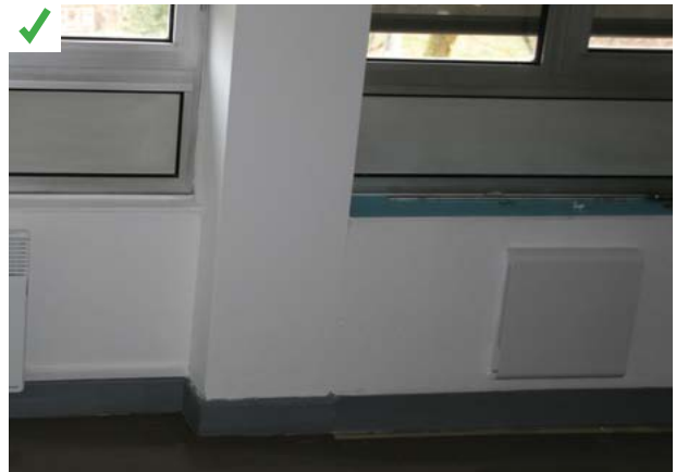
Le module de la ventilation double flux décentralisée est positionné en allège (à droite sur la photo). Le flux d'air est dirigé parallèlement au mur. Aucune gêne par courant d'air n'est ressentie par les usagers.
