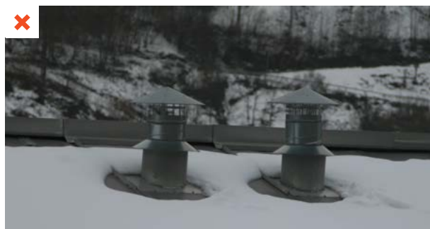
Bouches d'entrée et de sortie d'air en toiture très proches l'une de l'autre. ©AQC
