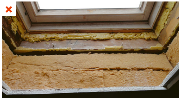
La jonction entre la menuiserie et le chevêtre est assurée par de la mousse expansive. Des vides sont présents entre les panneaux isolants et le chevêtre, ce qui crée un pont thermique. N.B. : Il existe en outre un problème de continuité de l'étanchéité à l'air avec le dormant. ©AQC
