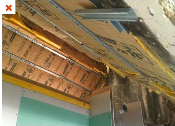
Les extrémités des panneaux isolant ploient sous leur propre poids, notamment au faîtage à la jonction entre les deux pans de toiture. ©M.Auriac
