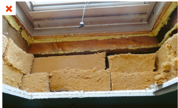
Le pourtour de la fenêtre de toit a été isolé avec des chutes de panneaux d'isolant, ce qui ne permet pas la continuité de l'isolation. ©AQC
