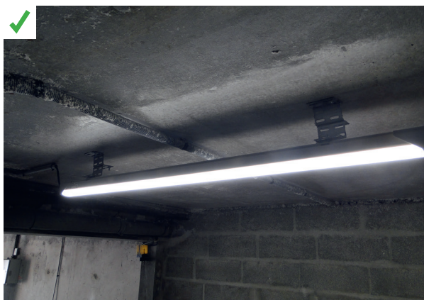
Les luminaires ont été décalés de la paroi pour permettre une projection continue de l'isolant sur toute la dalle. ©AQC
