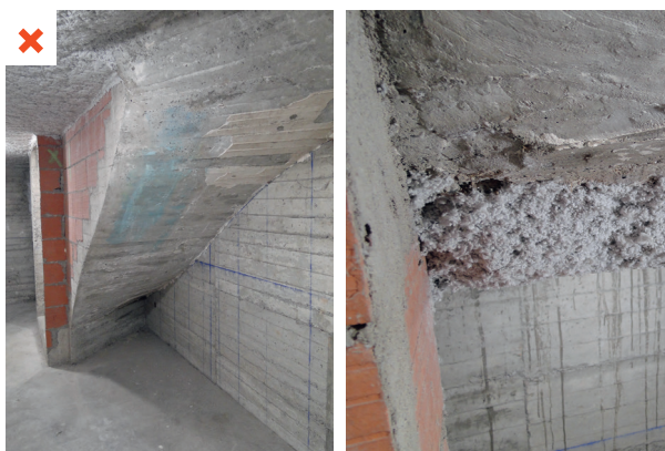
La cage d'escalier menant aux caves de cet immeuble n'a pas été isolée en même temps que la sous-face du plancher bas, ce qui entraîne une augmentation des déperditions des logements vers les circulations. ©AQC
