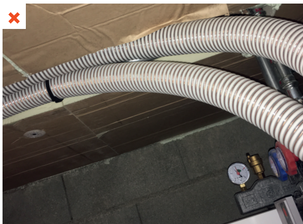
Les tuyaux de transfert des granulés de la chaudière, fixés à la dalle, n'ont pas été dévotés lors des travaux d'isolation. L'isolation n'est pas totalement continue. ©AQC
