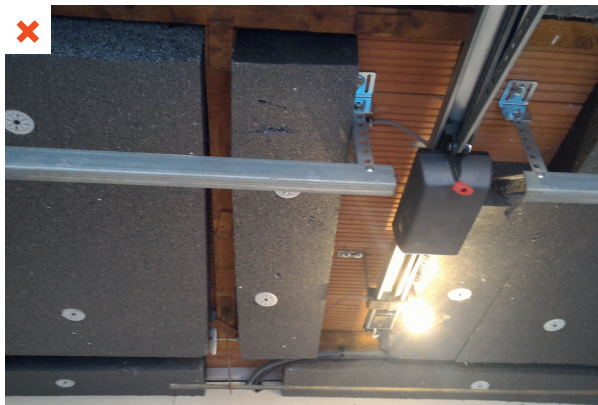
Les rails suspendus de la porte de garage basculante et des pièces de bois fixées au support, non déposés préalablement aux travaux d'isolation, ont gêné la réalisation de celle-ci. L'isolation n'est absolument pas continue. ©AQC
