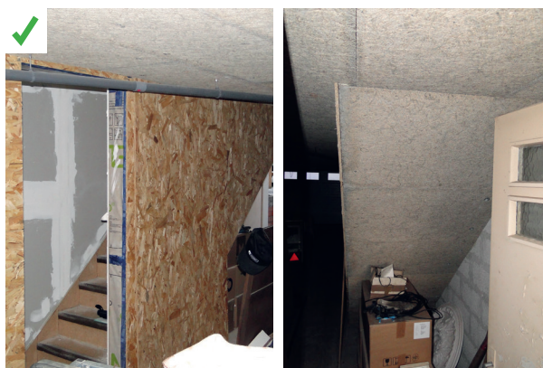
La cage d'escalier menant au garage a été entièrement isolée lors des travaux d'isolation du plancher bas. ©AQC
