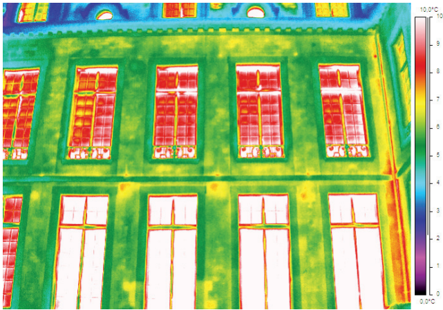
Rue des Francs-Bourgeois, 4 e arrondissement. Fuites thermiques occasionnées par les vitrages.
