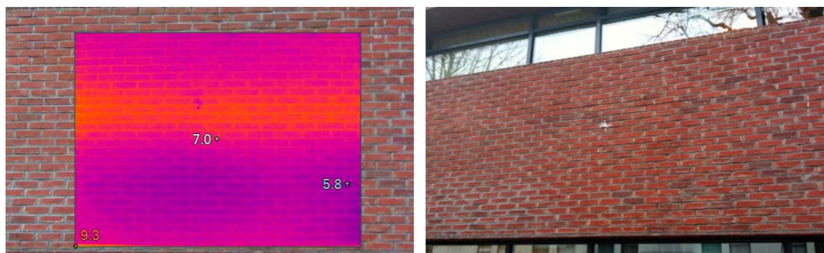
Mise en évidence d'un pont thermique (projet DPE_IITI Noisiel 2013)
