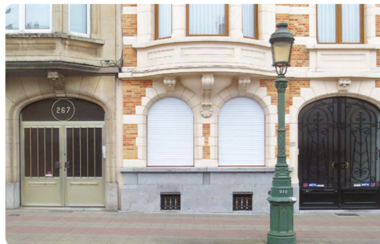
Remplacement de porte non respectueux du style de l'immeuble et des règles urbanistiques
