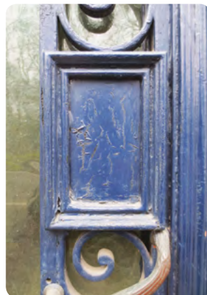
Peinture inadaptée au métal
