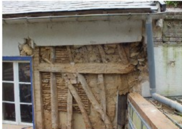
Un petit défaut de gouttière et un mur recouvert d'un enduit au ciment, ont provoqué un pourrissement des bois de structure qui ne pouvaient plus sécher.
