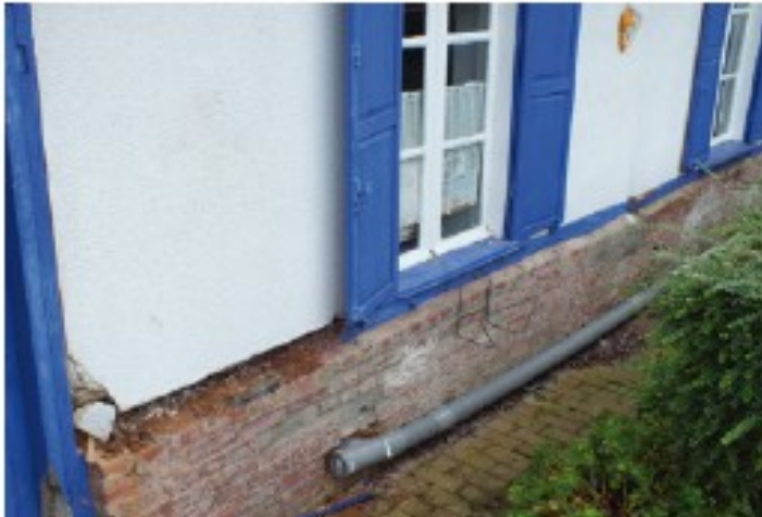
Peinture épaisse, mur enduit de ciment et isolation par l'intérieur avec pare-vapeur ont eu raison de la sablière.
