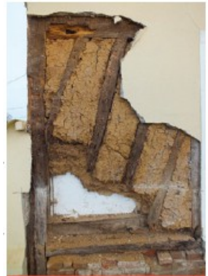
1) Un mur en pan de bois, victime d'un mauvais usage de matériaux contemporains (Polystyrène et enduit ciment)
