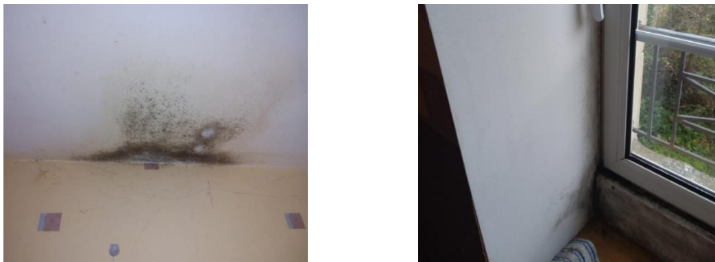
Figure 9 : Photo des moisissures constatées dans le bâtiment QSEL51
