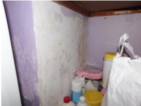
Figure 7 : Photo des moisissures constatées dans le bâtiment QSEL45
