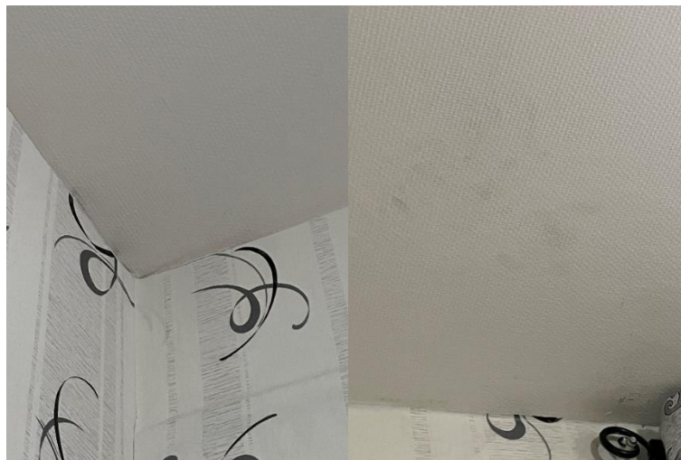
Figure 4: Photos des traces de moisissures prises dans le logement QSEL35 lors du diagnostic visuel
