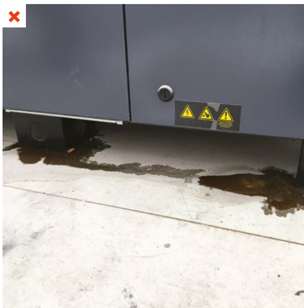
Défauts d'étanchéité à l'air et à l'eau au niveau de la porte de la CTA donnant sur l'échangeur. ©AQC
