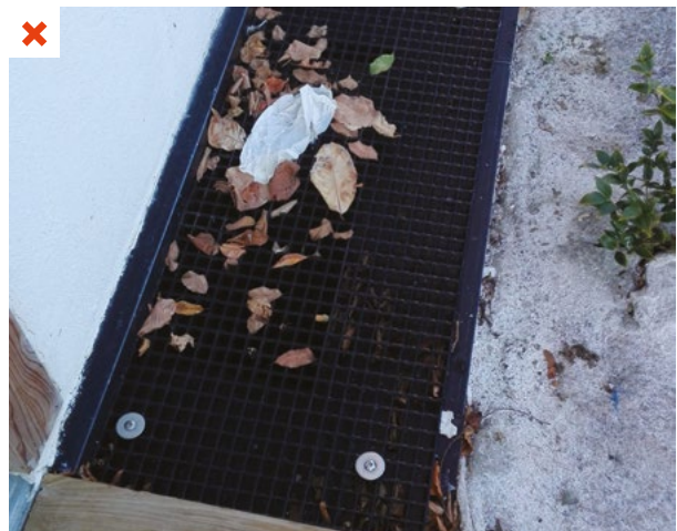
La prise d'air neuf au sol est obstruée par des feuilles et débris. ©AQC
