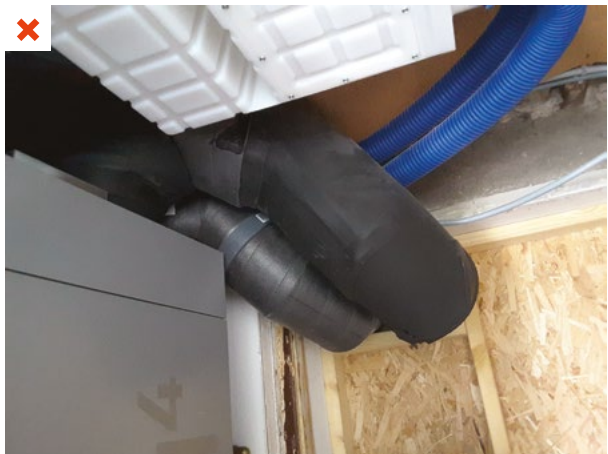
Les gaines de la prise et du rejet d'air sortent l'une à côté de l'autre sur la paroi extérieure. Cette installation a été réalisée dans le cadre d'une rénovation avec une contrainte d'espace. ©AQC
