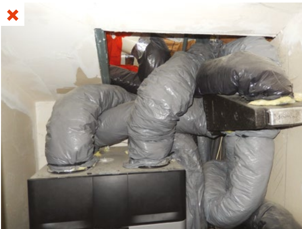
Des coudes et des écrasements de gaines souples sont présents à proximité immédiate de la CTA ce qui engendre des pertes de charges importantes. ©AQC
